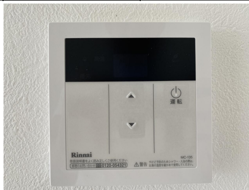
給湯設備付き
